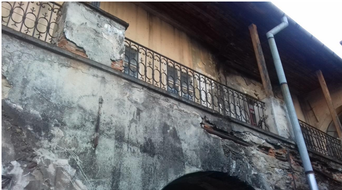
Fotografia č. 3 - 5 Vizualizácia narušeného stavu omietok severných dvorových fasád - zamočené, rozdrobené, zmyté, zasolené omietky, ktoré sú navyše porastené rozsiahlym riasovým a machovým porastom.
